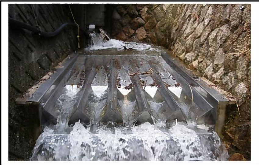
第1水源河床式除塵機
