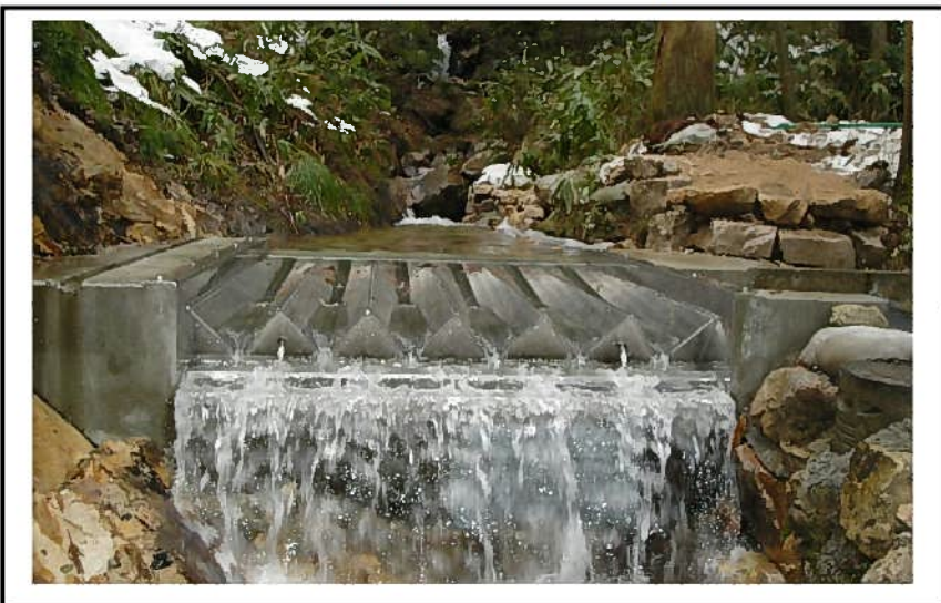
第2水源河床式除塵機
