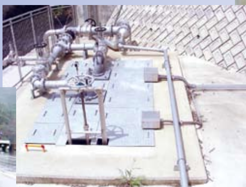
散水槽・散水ポンプ施設
