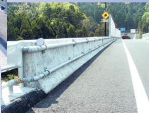
高欄部散水配管
